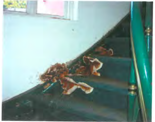
Figur 1. Ekte hussopp ( Serpula lacrymans ) er den alvorligste skadegjøreren i hus og er sammen med kjellersopp ( Coniophora puteana ) den hyppigst registrerte råtesopparten i norske hus.
