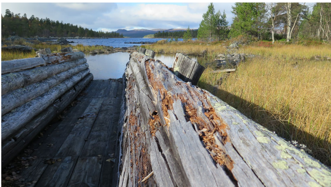
Råteskader i soleksponert del av tømmerrenne på Røros.
